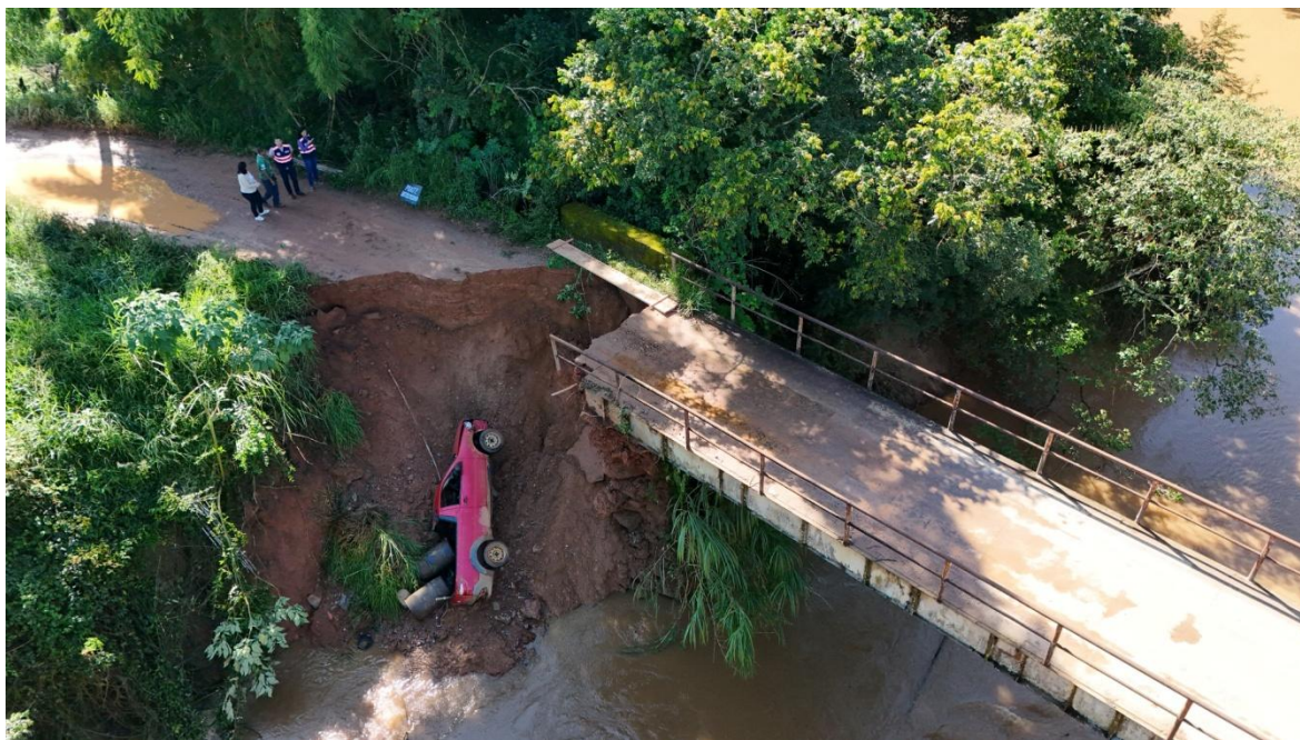
FOTO 01 – Vista aérea da ponte existente e do trecho de acesso comprometido, evidenciando o cedimento da cabeceira e a erosão junto ao encontro.
