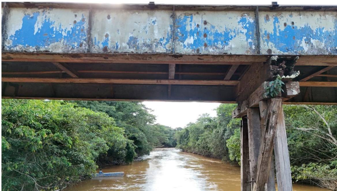
FOTO 05 – Vista inferior da ponte existente, evidenciando elementos metálicos e sinais aparentes de deterioração/corrosão da estrutura.
