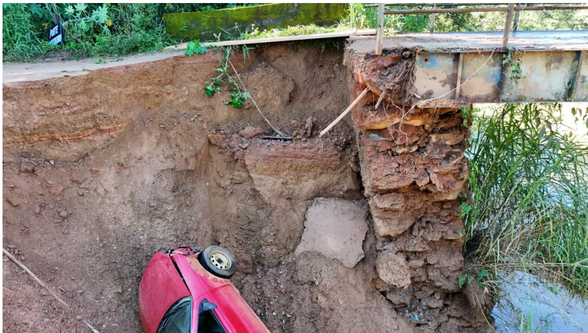
FOTO 03 – Detalhe da erosão e da deterioração dos elementos junto ao encontro da ponte, com perda de material e exposição da estrutura.
