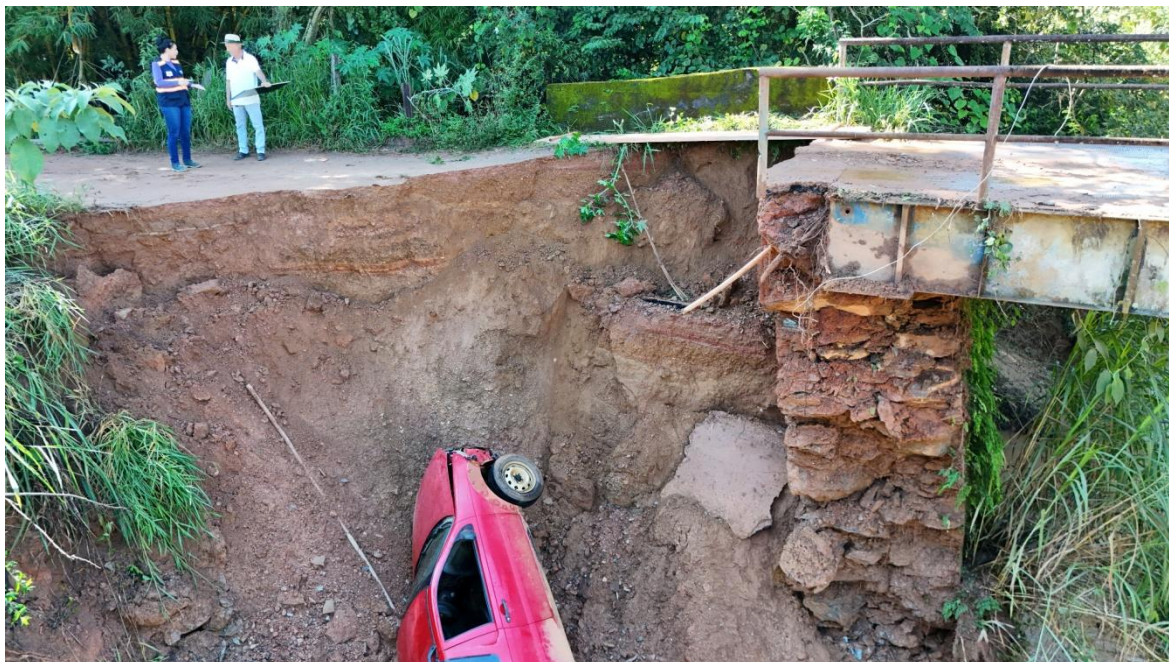
FOTO 02 – Vista do encontro da ponte existente, com erosão do aterro, exposição do terreno e comprometimento da região de acesso.
