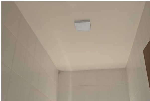
Figura 44: Sala esterilização corredor 03
